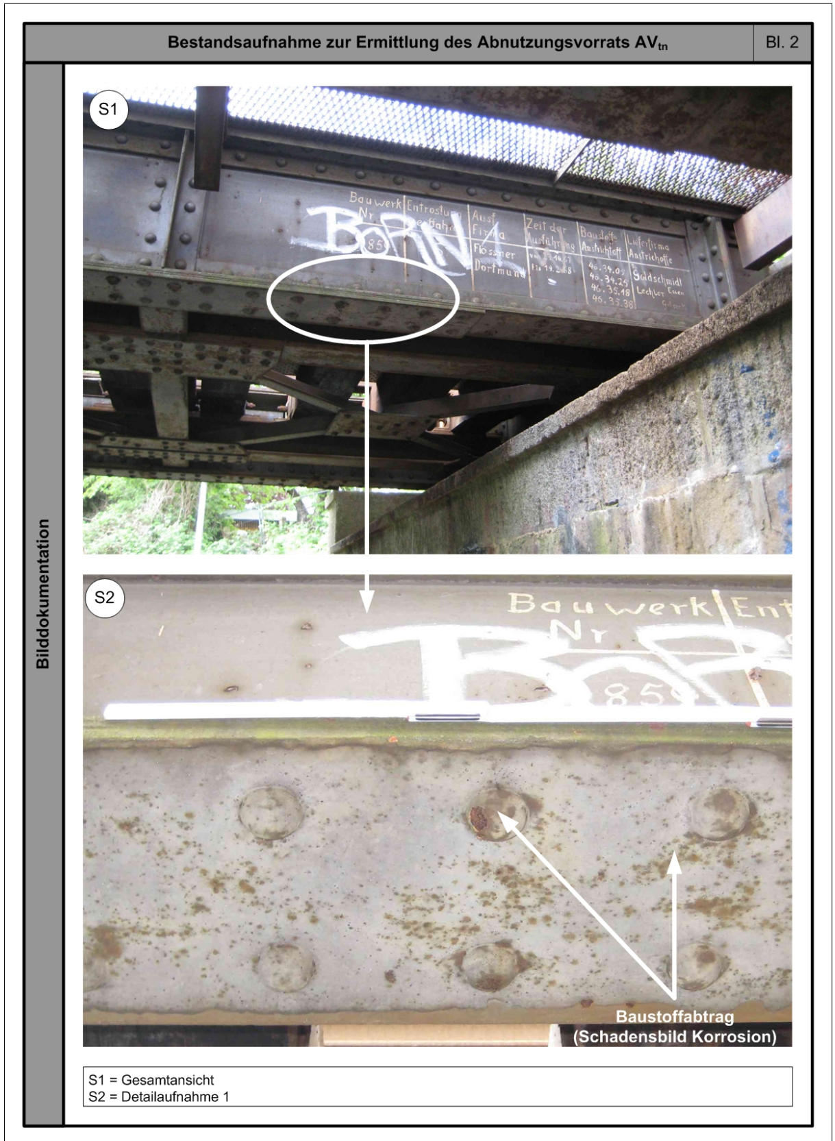
Abb. 379: Bestandsaufnahme zur Ermittlung des gegenwartsbezogenen Abnutzungsvorrats – Stahl (unlegiert), statisch relevante Bauelemente – Bl. 2
