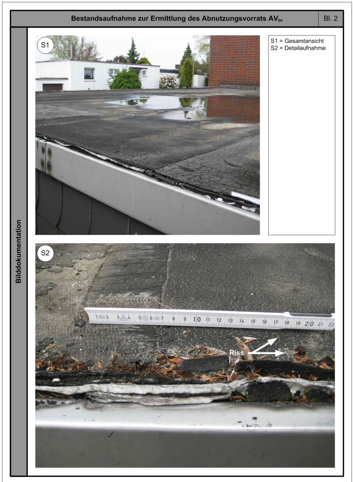
Abb. 190: Bestandsaufnahme zur Ermittlung des Abnutzungsvorrats – Bitumen – Bl. 2
