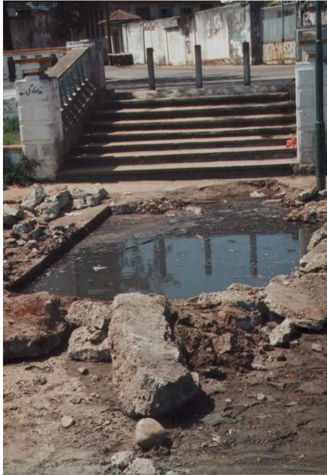
Abb. 6-11: Erkennbare Schäden am Abwassersystem in Bandar-e-Anzali – durch den hohen Pegelstand wird Abwasser an der Uferpromenade an die Oberfläche gedrückt und unterspült Verkehrsanlagen und Fundamente
