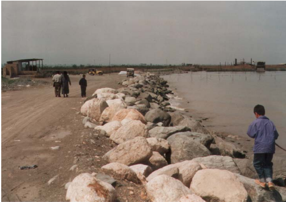
Abb. 4-16: »Schutzmaßnahmen« im Raum Bandar-e-Gaz; erkennbar ist ein völlig unzureichender Schutz gegenüber Wellengang sowie gegenüber einem weiteren Anstieg, bei dem diese lose Steinschüttung einfach überspült würde
