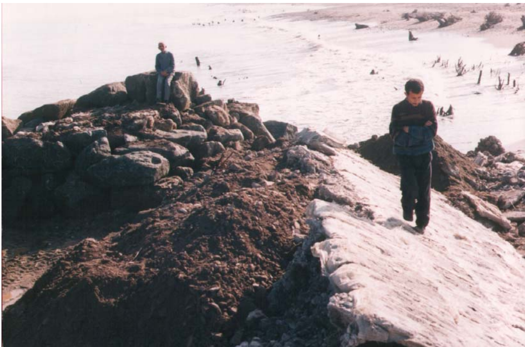
Abb. 4-17: Geborstener Schutzwall in Kalachai
