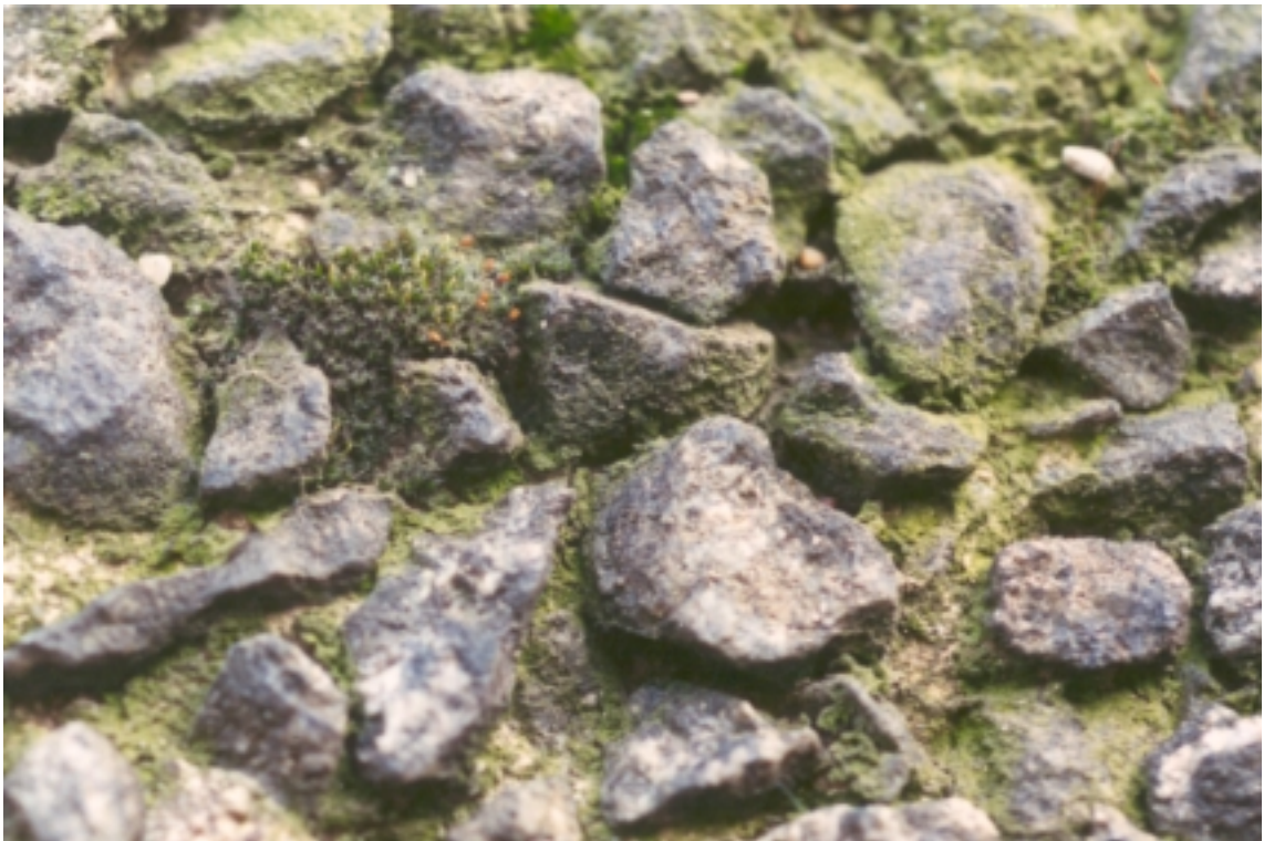
Abb. 6: Befall mit Mikroorganismen an einer Waschbetonfassade
