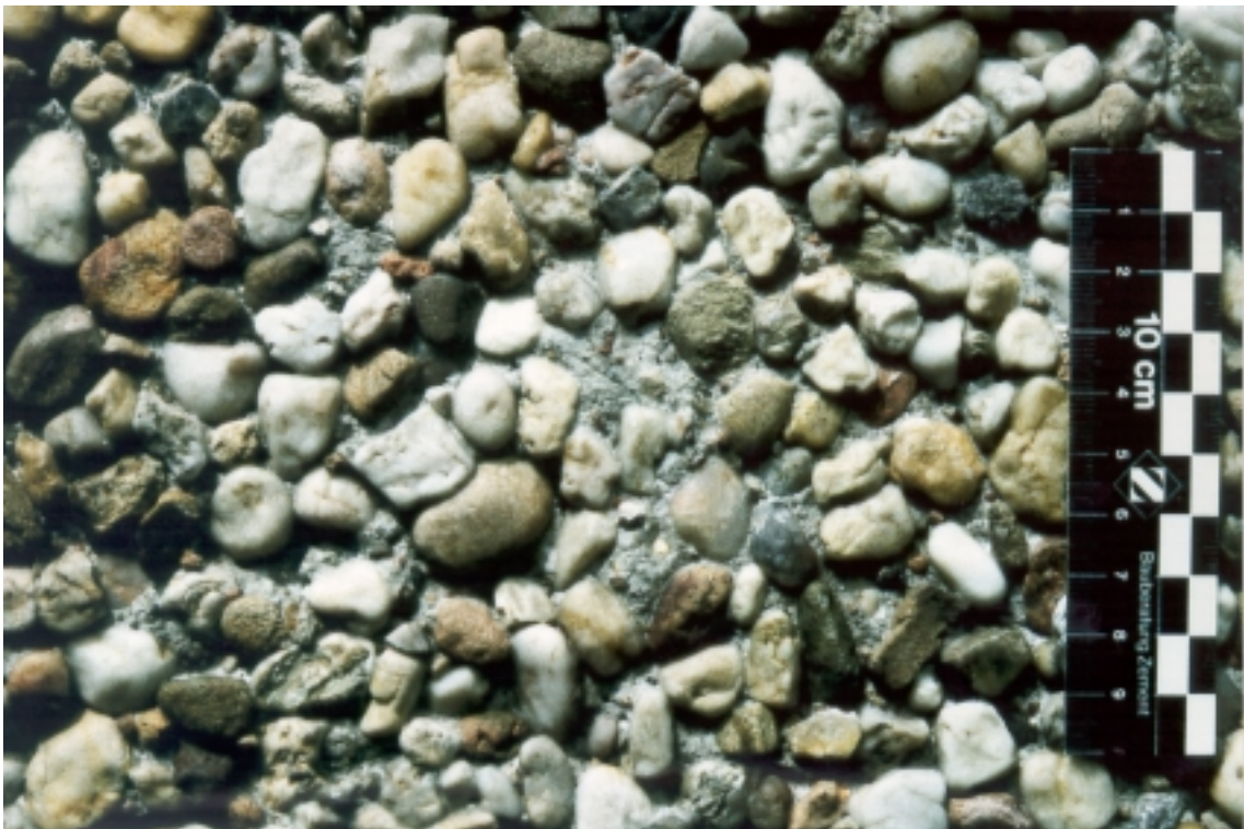
Abb. 1: Ausgewaschene Betonoberfläche, Rauhtiefe ca. 6 mm
