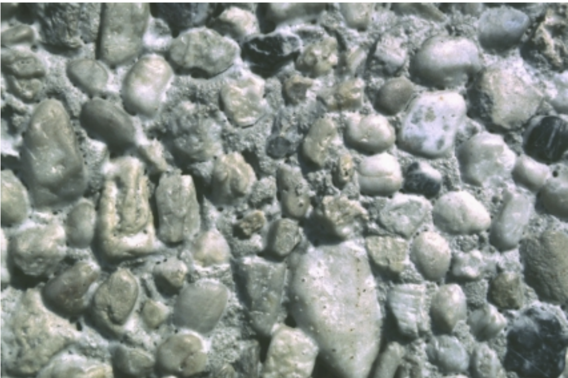
Abb. 14: Fehlstellen in einer lasierenden Waschbetonbeschichtung
