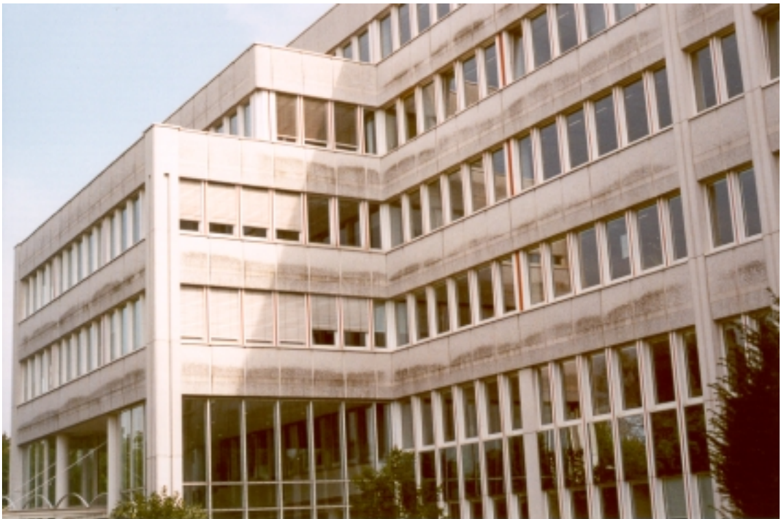
Abb. 5: Verschmutzung einer weißen Waschbetonfassade
