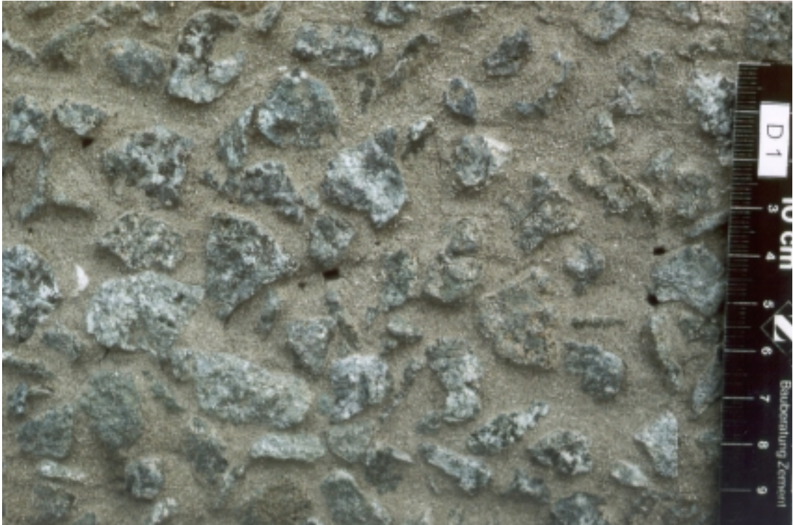
Abb. 23: Fehlstellen im PCC-Mörtel nach dem Ausstrahlen
