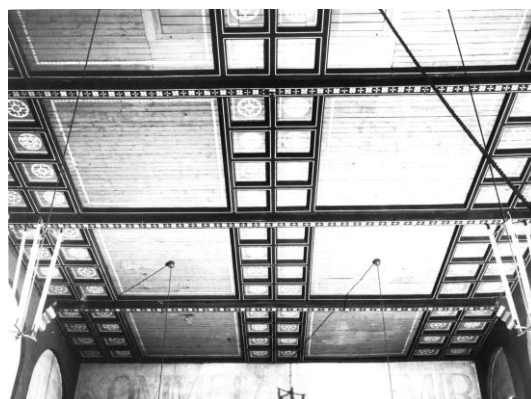
Abb. 13 – Ehemalige Fassung der Holzkassettendecke des Kirchenschiffs [AJB]
