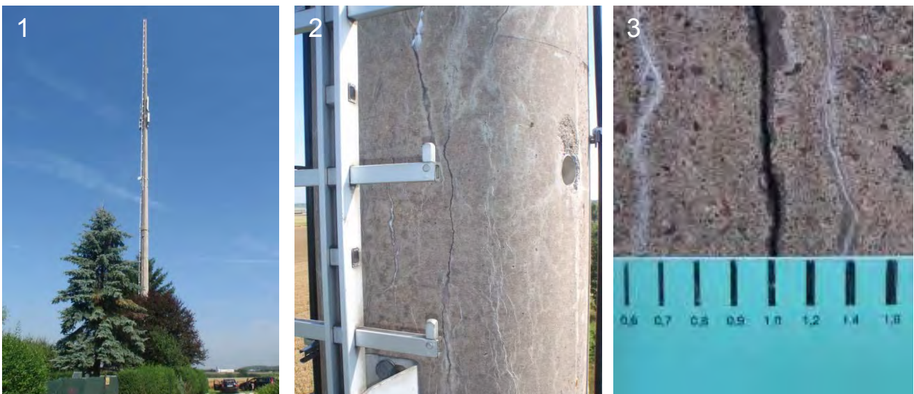
Bild 11: Trennrisse durch Ettringitreiben an einem Betonmast
