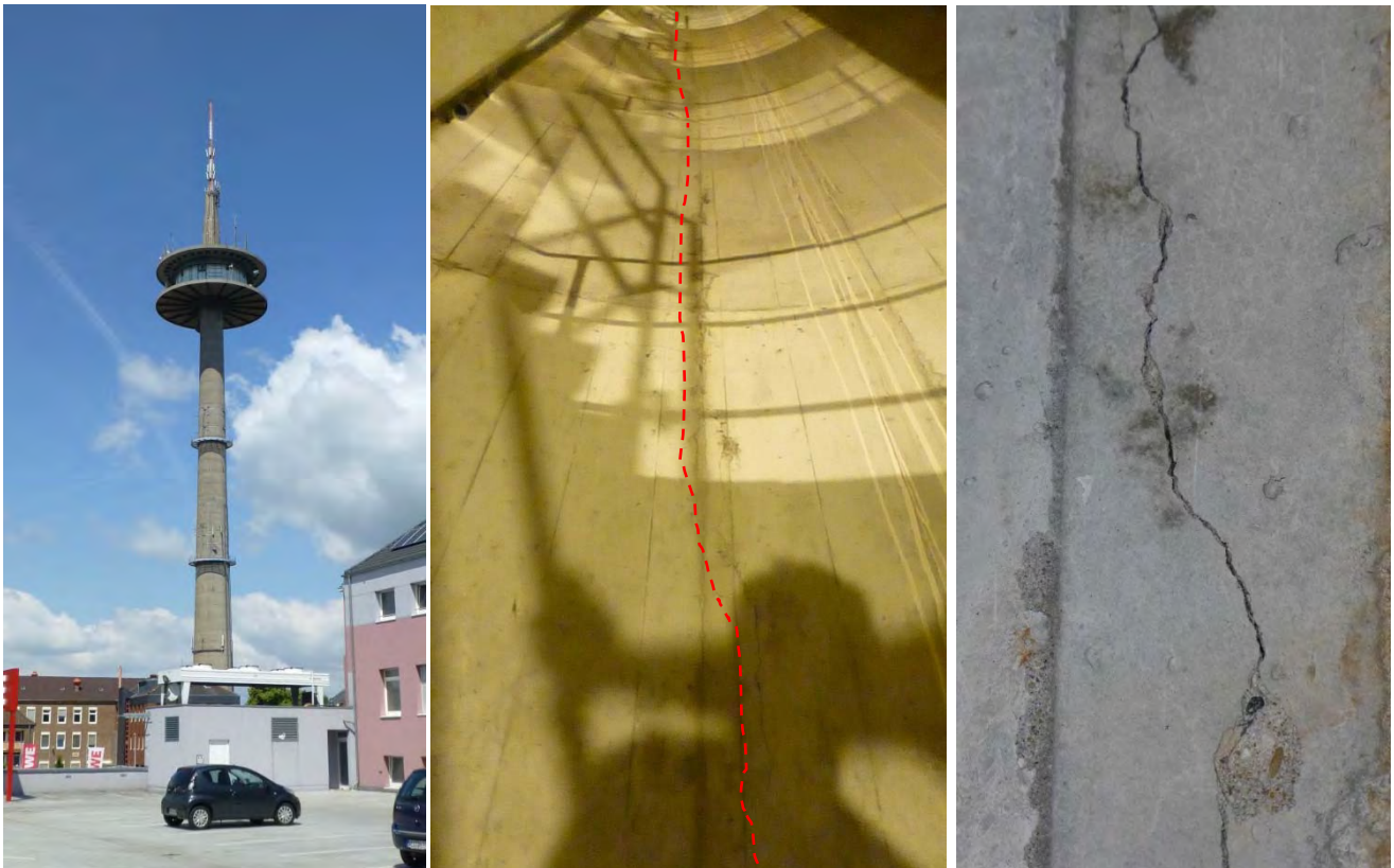
Bild 96: Breite Vertikalrisse an der Schaftinnenseite Betonturm Wesel
