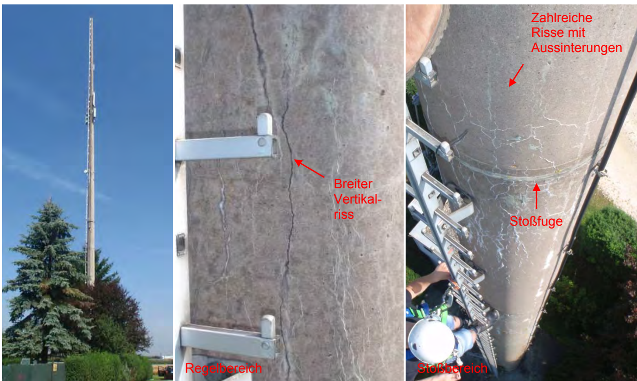
Bild 93: Vertikalrisse am Funkmast in Ulm
