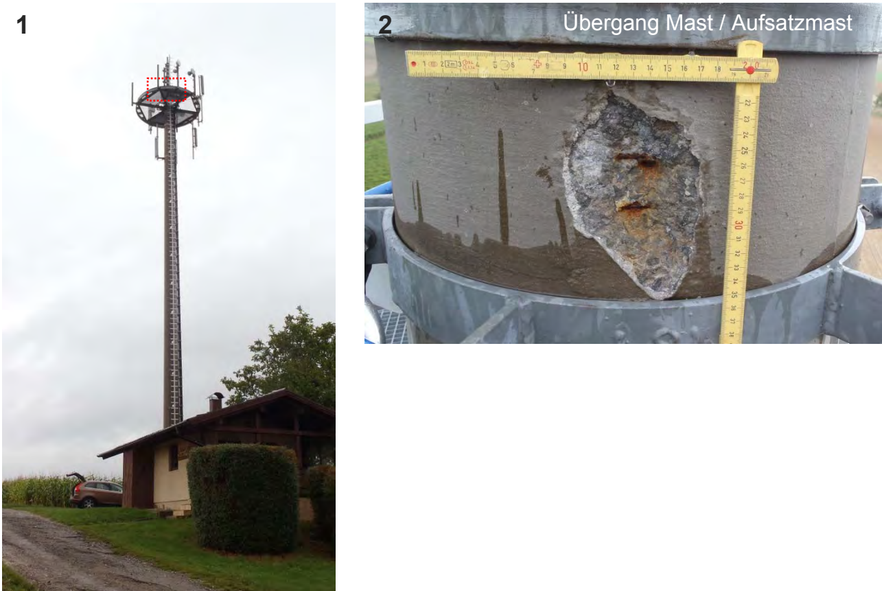
Bild 13: Betonabplatzung mit korrodierter Wendelbewehrung am oberen Ende des Betonmastes im Bereich der Verankerung des Aufsatzmastes
