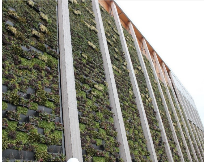
Abbildung 57: Grünfassade der Leeds RERF
