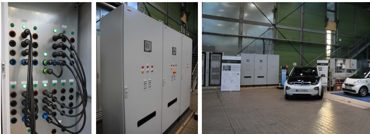
Impressionen aus dem SGT Lab: links Verteilerschrank Mitte: AC und DC Verteilerschränke
