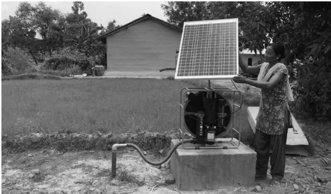
Abbildung 2: Solarbetriebene Wasserpumpe für Einzelhaushalte (Quelle: Nepalitimes).
